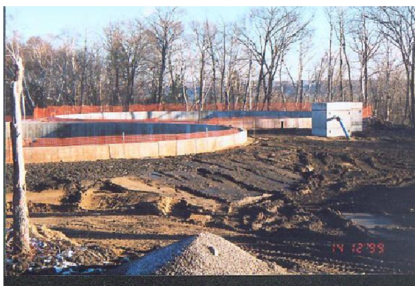
Bassins de décantation des eaux usées 14 décembre 1999
