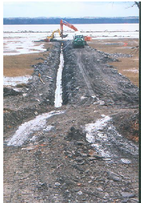
Tuyau de dégagement en cas de déversement des bassins, 4 novembre 1999
